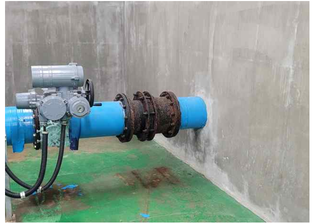
손상내용 유입밸브실 배관 부식 손상원인 공용열화
