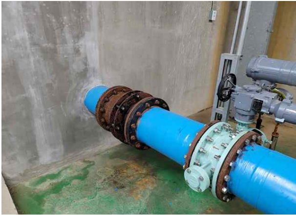
손상내용 유입밸브실 배관 부식 손상원인 공용열화
