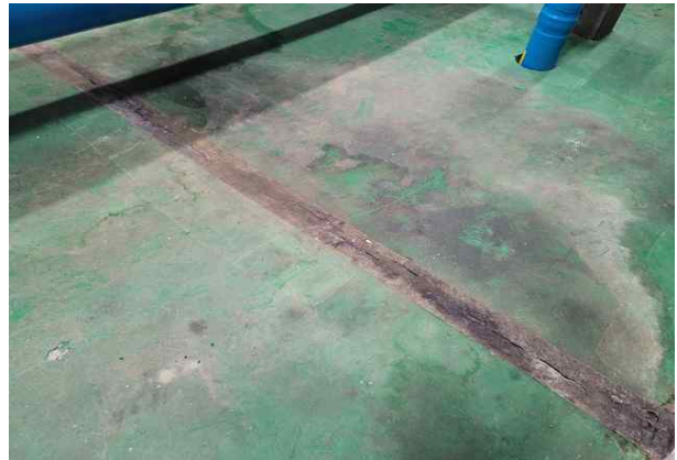
손상내용 유입밸브실 바닥슬래브 실링재 열화 손상원인 공용기간 중 열화
