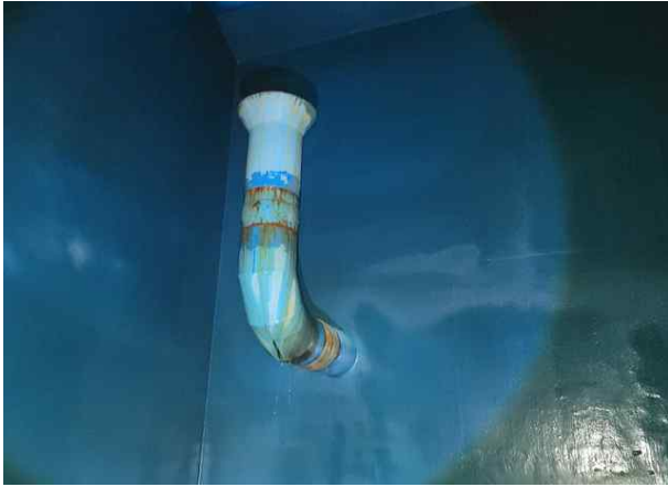
손상내용 1지 유입배관 부식 손상원인 공용열화
