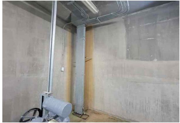
손상내용 유입밸브실 벽체 누수흔적 손상원인 수분접촉, 배관누수
