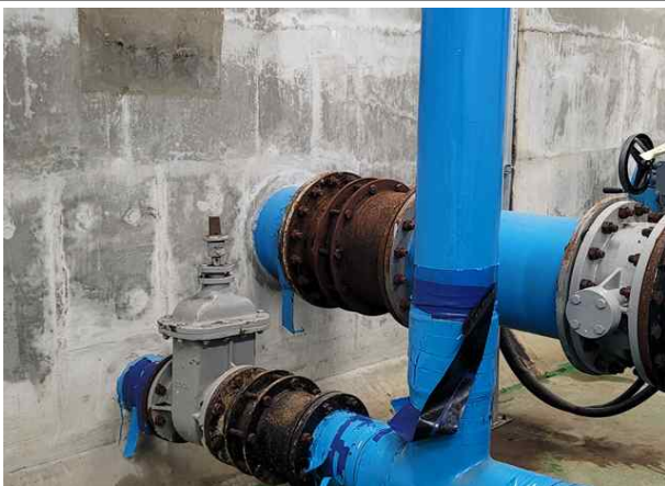
손상내용 유출밸브실 배관 부식 손상원인 공용열화
