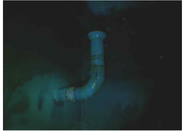
손상내용 2지 유입배관 부식 손상원인 공용열화
