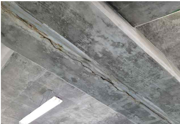
손상내용 유출밸브실 보 박리 손상원인 동결융해 반복, 시공미흡
