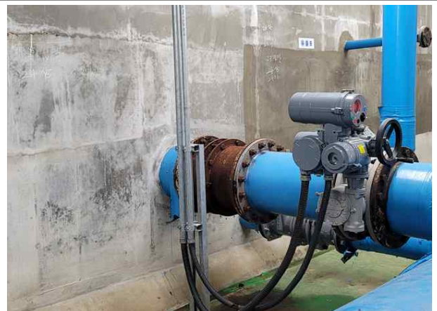
손상내용 유출밸브실 배관 부식 손상원인 공용열화
