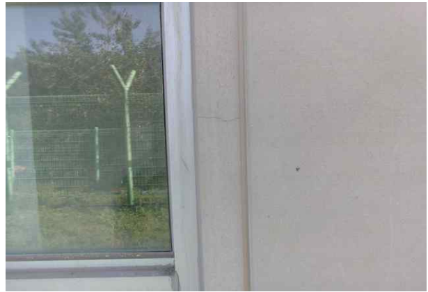
손상내용 전기실 외부 벽체 균열 손상원인 건조수축, 온도변화
