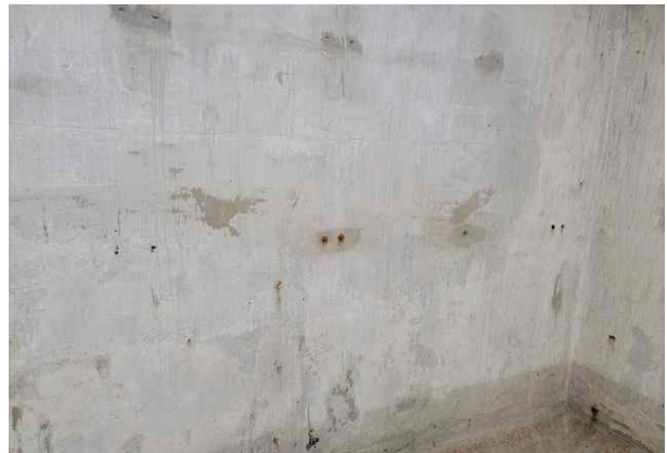
손상내용 유출밸브실 벽체 잡철물 손상원인 피복부족
