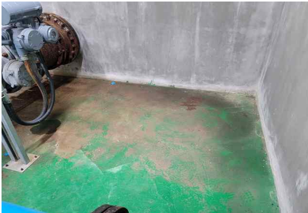
손상내용 유입밸브실 바닥슬래브 체수흔적 손상원인 외부우수 유입
