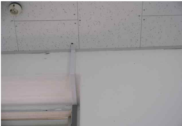
손상내용 전기실 내부 벽체 균열 손상원인 건조수축, 온도변화
