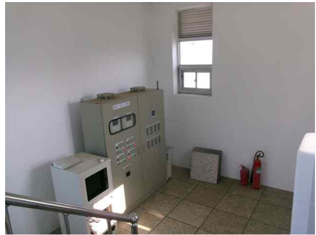
전기실 내부 전경
