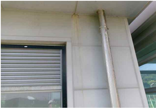
손상내용 전기실 외부 누수흔적 손상원인 수분접촉
